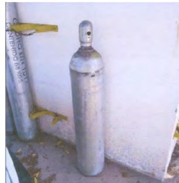
Figura 1. Tanque de gas cloro.
