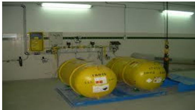
Figura 1: Tanques de gas cloro
