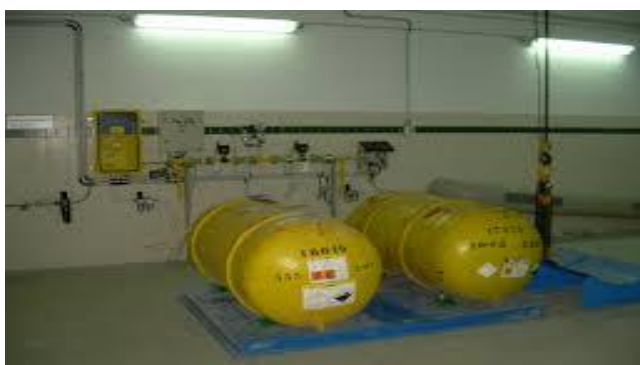
Figura 1: Tanques de gas cloro
