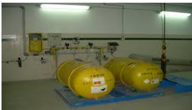
Figura 1: Tanques de gas cloro
